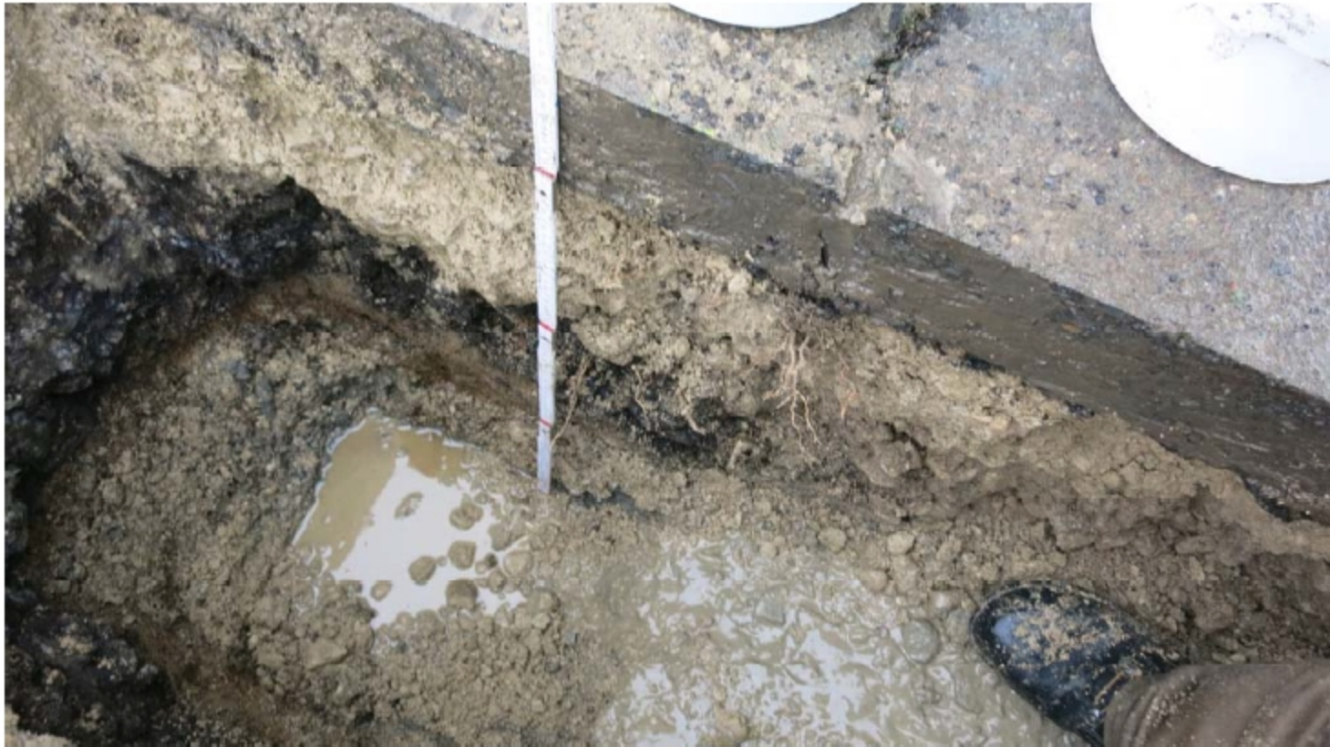
Schurf C: Riss im neuen oberen Asphalt über dem östlichen Ende des alten Asphaltes
